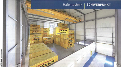
Die Standard-Krananlage mit einer Spannweite von 22.000 Millimetern kann bis zu fünf 20-Fuß-Container übereinander stapeln.
